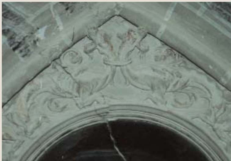
Pareja de grietas afrontados del ventanal septentrional del tramo recto del presbiterio de la catedral de Santa María de la Huerta de Tarazona en 1994.
