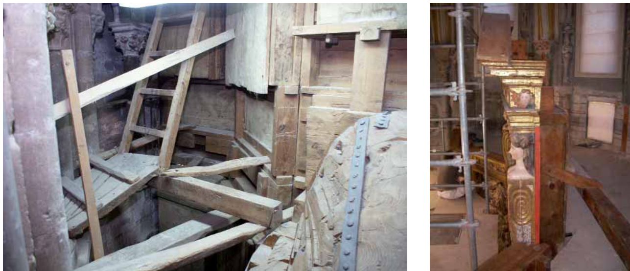
Figs. 52 y 53. Estructura auxiliar de acceso y entramado de vigas y viguetillas. Retablo mayor de la catedral de N a S a de la Huerta de Tarazona. Fotos Olga Cantos.
