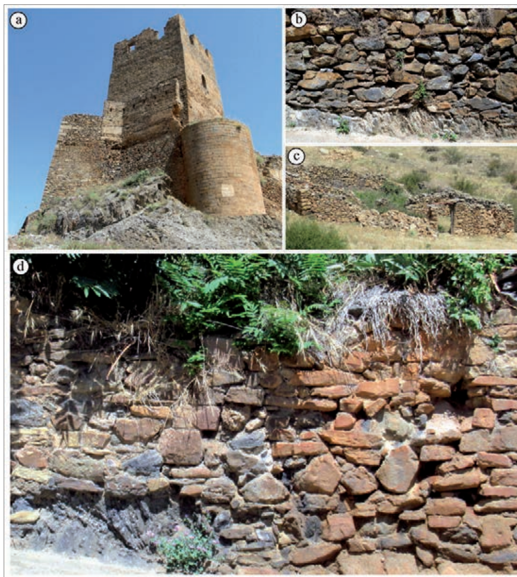
Figura 6. Estilos constructivos del Queiles: a) Castillo de Vozmediano apoyado sobre calizas y margas jurásicas y con empleo principal de bloques de arenisca en la construcción (nótese el carácter subredondeado de los cantos que define que su origen no es de obtención directa de afloramiento, sino que procede de niveles que han sufrido transporte –procedencia glacis cuaternario de la zona–). b) Uso de bloques de piedra en construcción de estructuras de escasa importancia utilizando bloques obtenidos de afloramientos próximos. c) Uso de materiales constructivos para construcción de estructuras de escasa importancia a partir de bloques procedentes de los glacis de la zona que provienen de materiales jurásicos y cretácicos. d) Dos fases de construcción de muro perimetral con uso de materiales locales extraídos para la construcción con variación del contenido en bloques de tipo margoso (lábil) y selección de bloques areniscosos (derecha; fotografía de Vozmediano).
